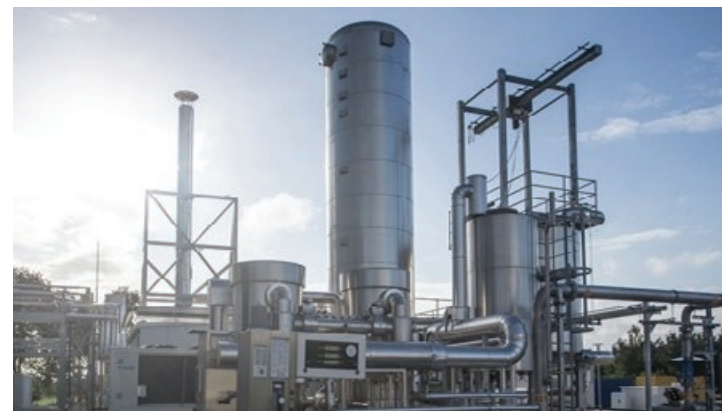
Figure 7 : Usine Audi e-gas de Werlte (Allemagne)
