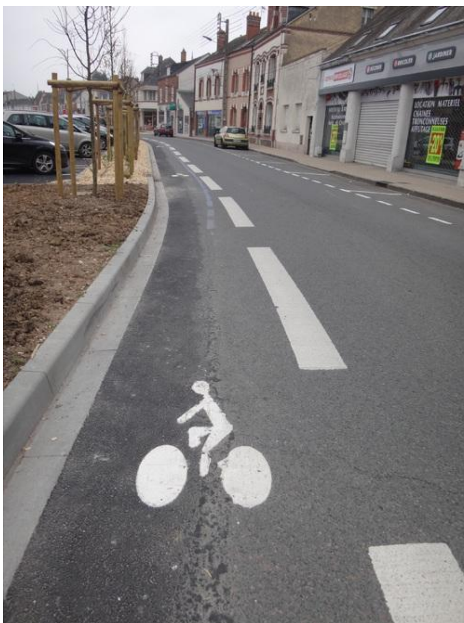
La nouvelle piste cyclable du boulevard Jeanne d'Arc - Cliquer sur la photo pour l'agrandir
