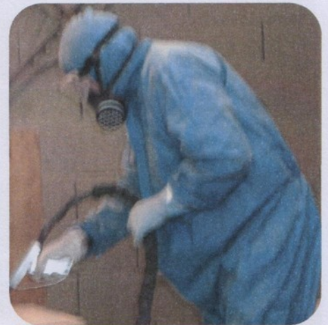
Le poste de sablage
