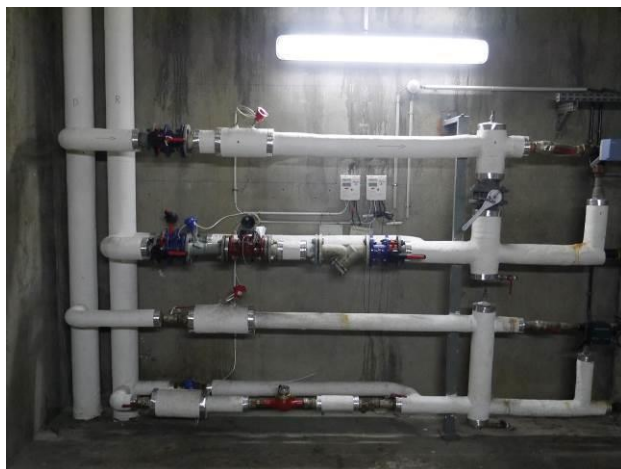
Photo de l'installation :
