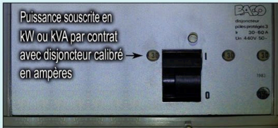
Exemple Disjoncteur triphasé calibré à 30 Ampères par phase par EDF pour abonnements actuels 18 kW ou 18 kVA
