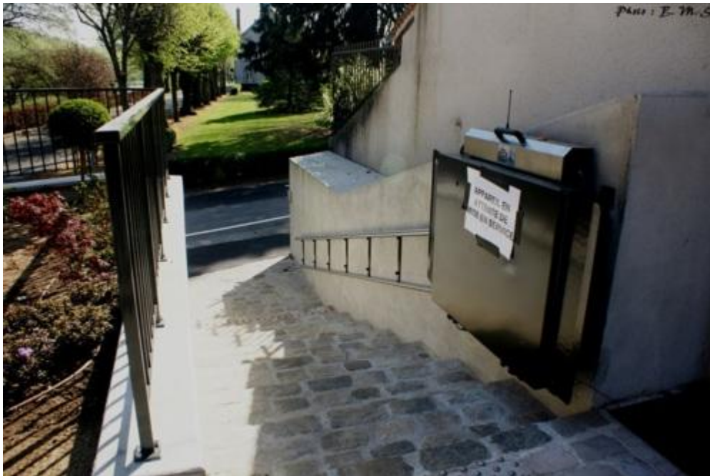
Le monte-escalier pour PMR (escalier de la rue du Bout du Monde). Photo B. M.-S. Cliquer sur la photo pour l'agrandir.
