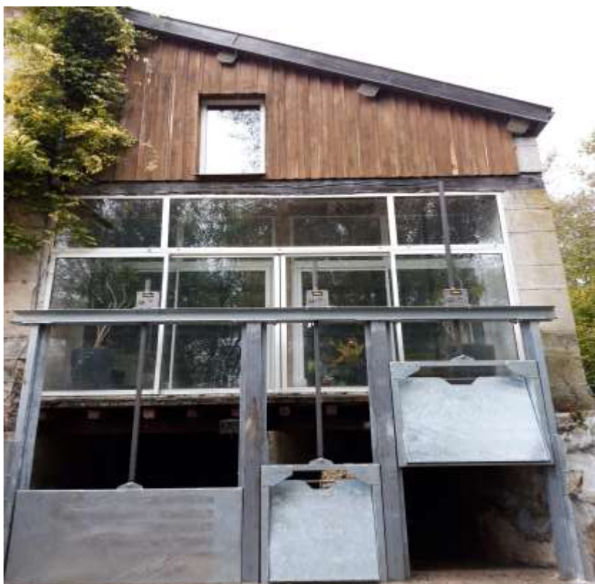
Photo (haut) réalisée après pose des vannes, crémaillères. Choix pour 2 vannes en autorégulation et 1 vanne « classique ». Le vannage est prêt à fonctionner après mise en eau.
