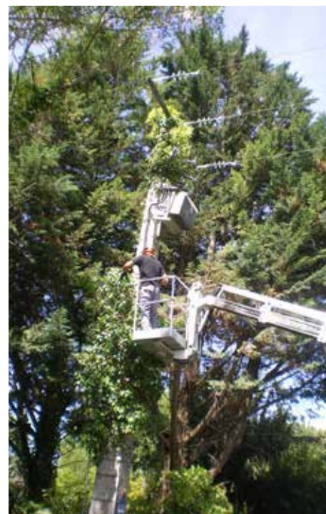
▲ À La Reuille, la végétation envahissant les lignes électriques nécessitait l'intervention en urgence des élagueurs.
